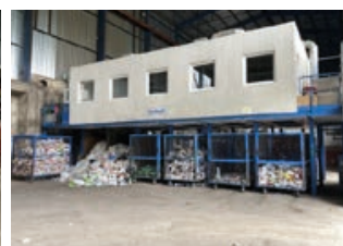
Třídárna s odpadovými klecemi
